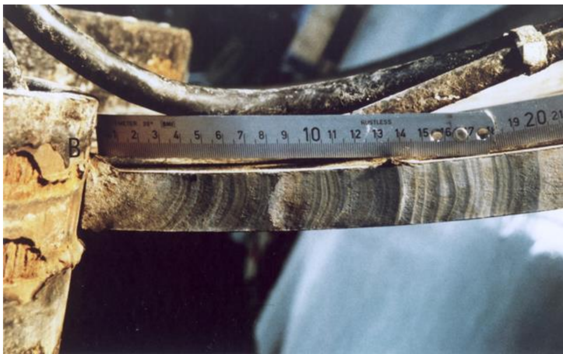
Årringer i utmattingsbruddet på D6-staget. Foto: Bjørn Lian.
